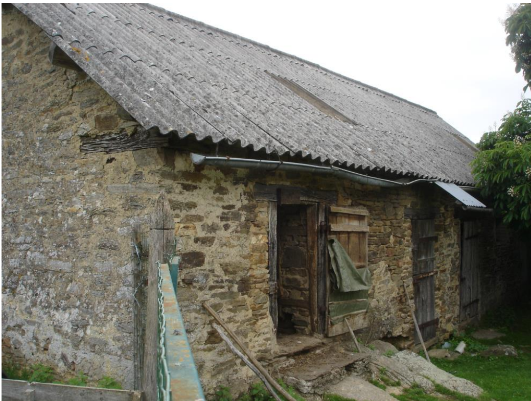
Etable mentionné dans l'Etat des fonds de 1749 Les granges ovalaires étaient situées de part et d'autre de ce bâtiment
